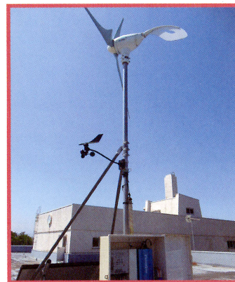
風力発電装置
